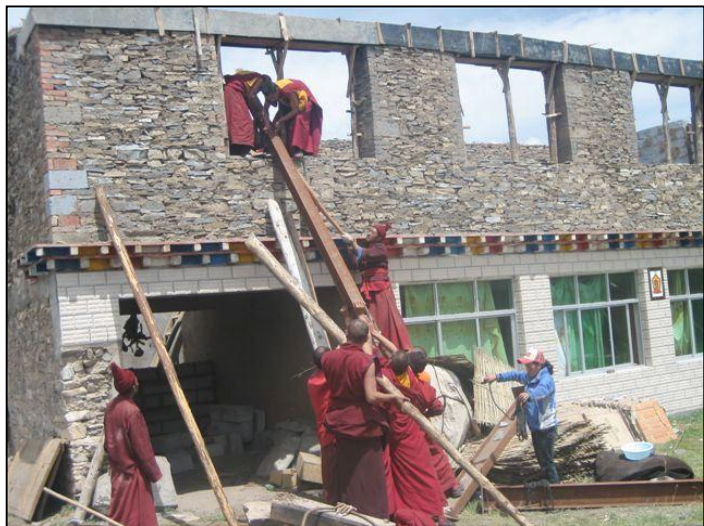
Spital Kashi - Alle helfen mit beim Bau des oberen Stockes der Krankenstation, Mönche wie Laien
